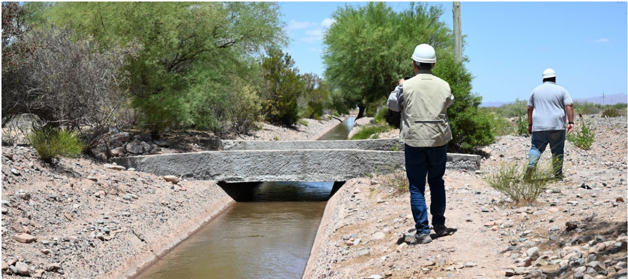
SISTEMA DE READECUACIÓN DEL AGUA
